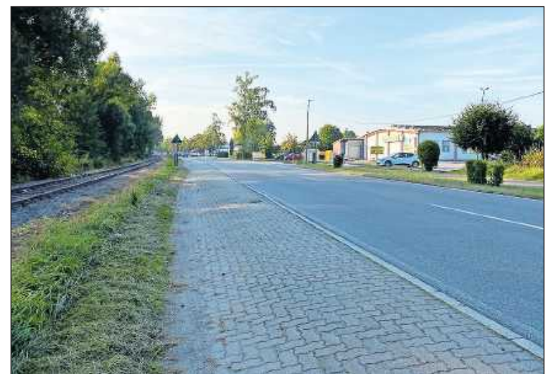
Der gepflasterte Seitenstreifen hat sich wegen häufig dort parkender Lastwagen deutlich abgesenkt. FOTO: JÖRG PETRI
